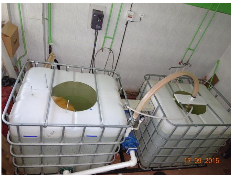
Рис. 1 - Общий вид безреагентного модуля для очистки сточных вод
